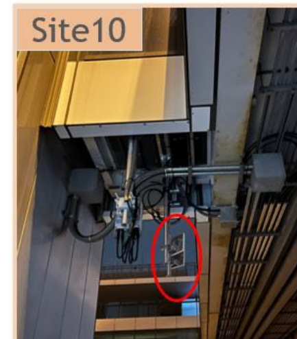
配管類を避けて配置
