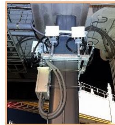
南向きアンテナ
