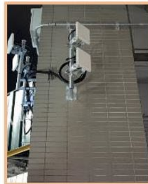
南向きアンテナ
