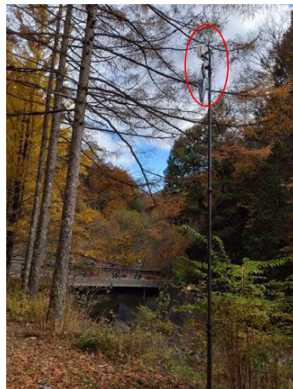
中継機設置状況
