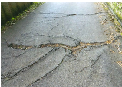
▲木の根が浮き上がり道が凸凹で自転車を通る際に危険！
