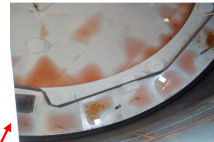
【内部浮き蓋上の滞油の状況】
