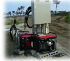
可搬型発電機
