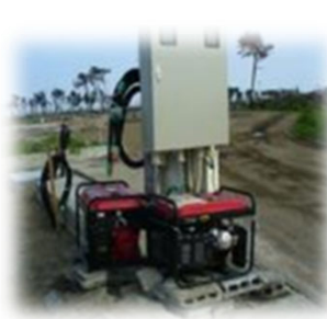
可搬型発電機
