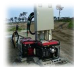
可搬型発電機
