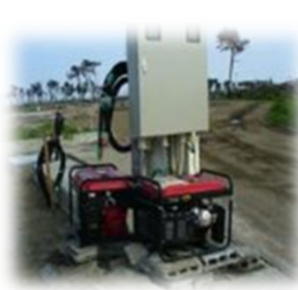
可搬型発電機
