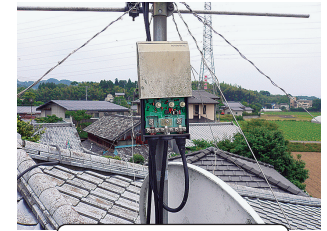
経年劣化したブースター
