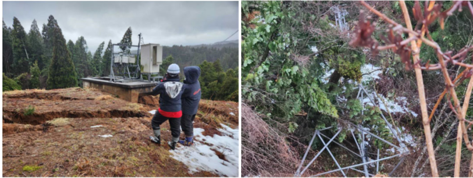
倒壊した基地局
