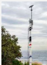
衛星回線を活用した基地局
