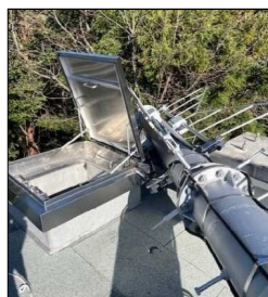
送信アンテナの損壊
