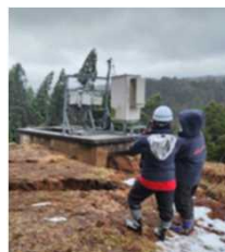
基地局の損壊
