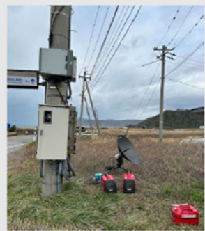
衛星回線/発電機
