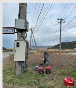
衛星回線/発電機
