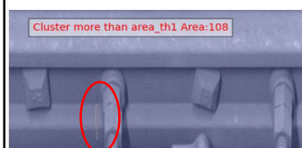
AIによる不良箇所検知例(継目板き裂)
