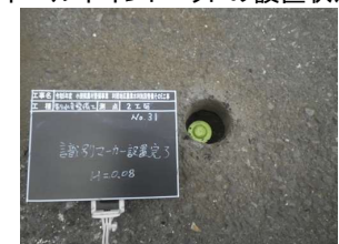
マーカローケーティングシステムの設置状況
