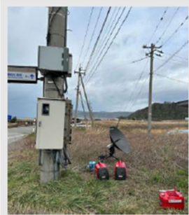
衛星回線/発電機
