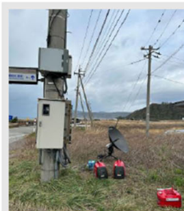
衛星回線/発電機
