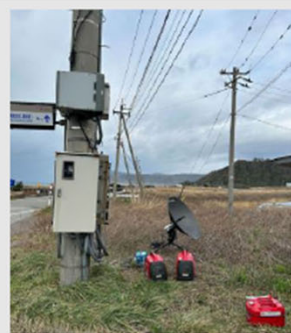
衛星回線/発電機
