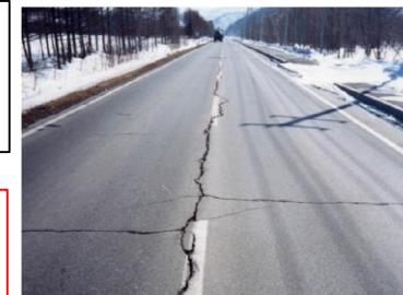
凍上災害による 舗装の損傷事例
