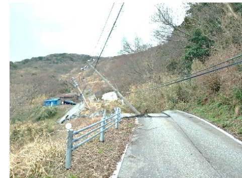
道路の寸断・損傷 (道路啓開に係る他機関との連携)
