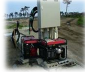
可搬型発電機
