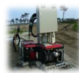
可搬型発電機
