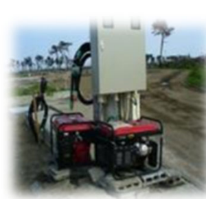
可搬型発電機
