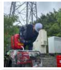
基地局等への可搬型 発電機の設置や燃料確保
