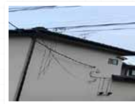
引込線の断線
