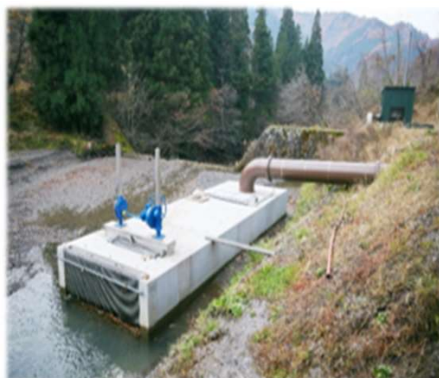
小水力発電施設
