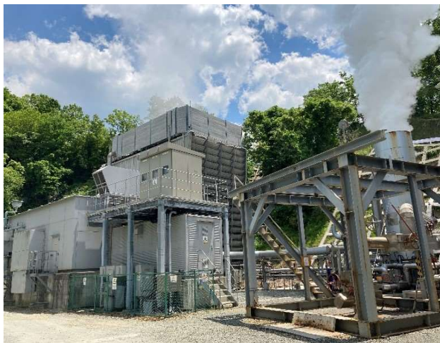
隣地にて稼働中の地熱発電所1号機
