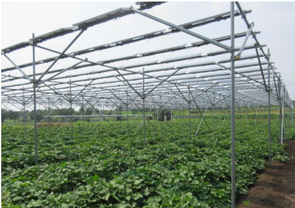
露地の畑の上部にパネルを設置
