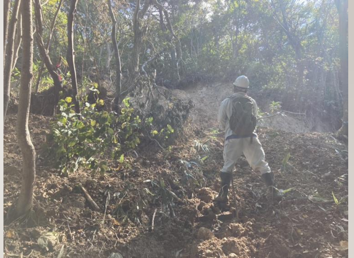
中継局までの出向路 崩落
