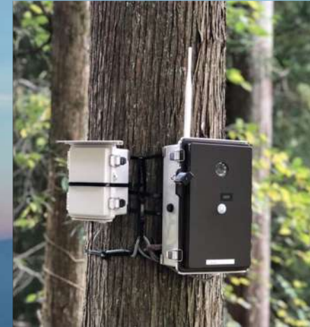
GeoCam（カメラ映像監視）
