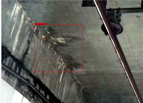
トンネル天井漏水の検出例
