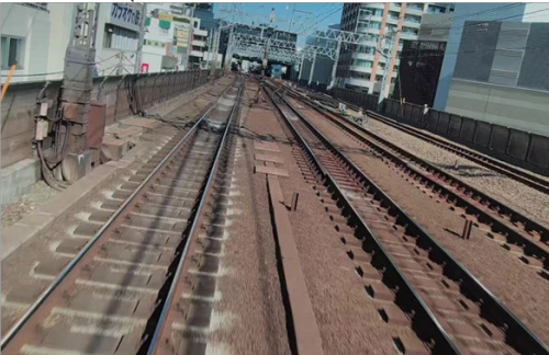
誤検出例（余盛のない区間を誤って検知した例）
