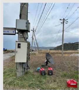
衛星回線/発電機
