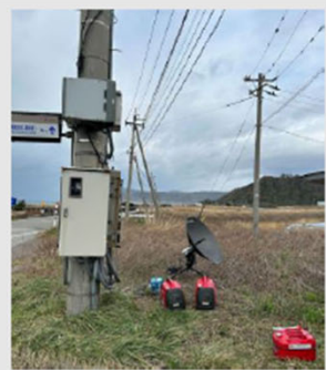
衛星回線/発電機
