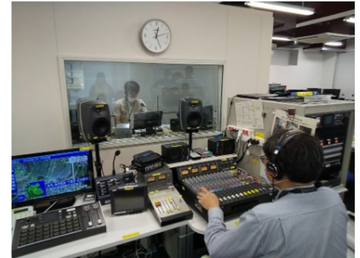
<さいたま放送局の非常用のラジオ放送設備>
