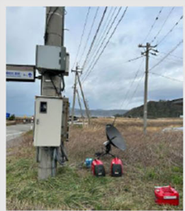
衛星回線/発電機
