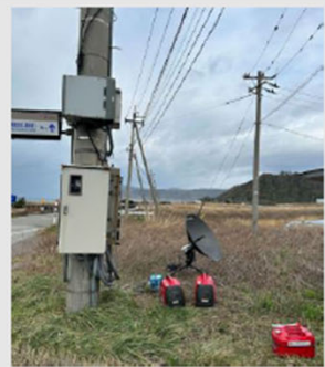
衛星回線/発電機
