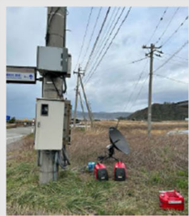
衛星回線/発電機
