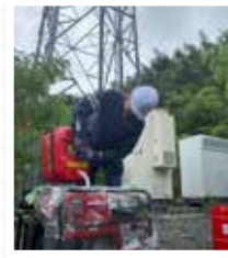
基地局等への可搬型 発電機の設置や燃料確保
