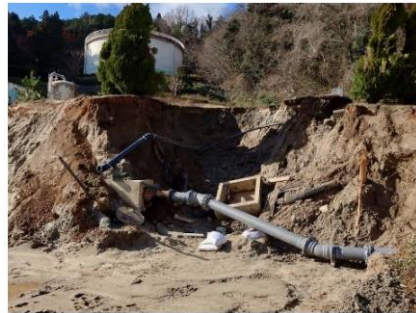
浄水場内の配管損傷(七尾市)
