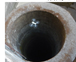
サージタンク
