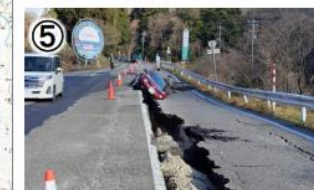
⑤ 国道249号 (穴水町志ケ浦)
