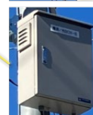
電源ボックス
