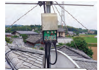
経年劣化したブースター
