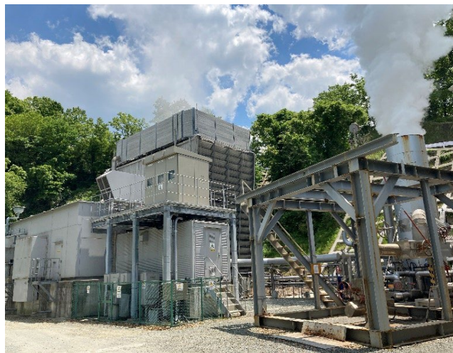
隣地にて稼働中の地熱発電所1号機
