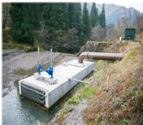
小水力発電施設
