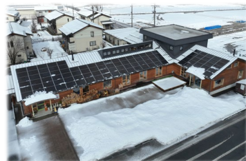
融雪機能付き太陽光パネル
