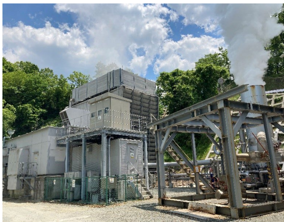
隣地にて稼働中の地熱発電所1号機
