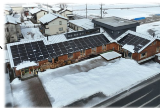
融雪機能付き太陽光パネル
