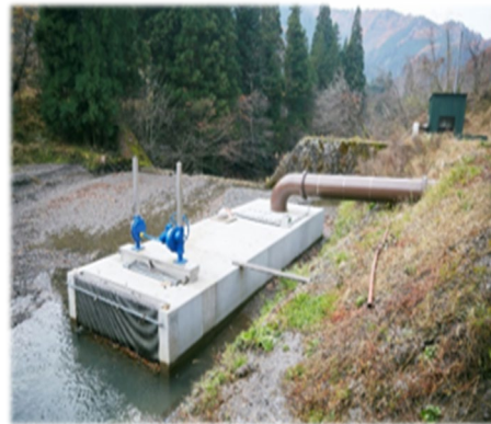
小水力発電施設
