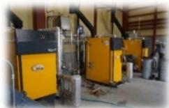
バイオマスボイラー
