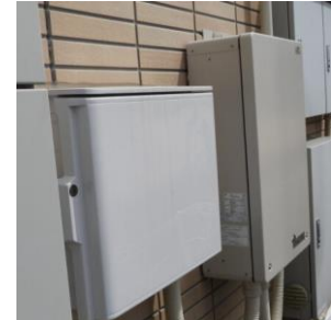
太陽光発電設備
