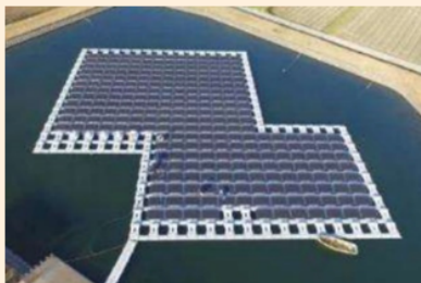
ため池フロートソーラー発電所
