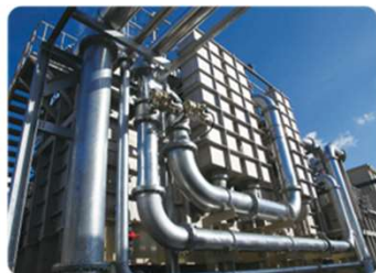
下水処理設備
