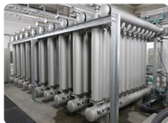
上水処理設備
