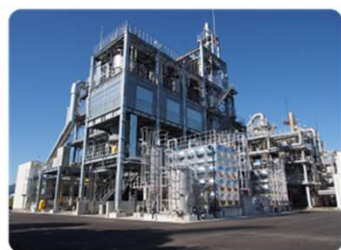
汚泥処理設備
