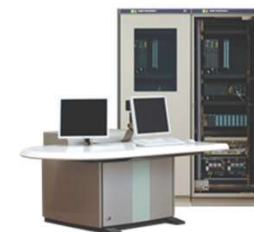
監視制御設備
