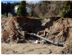
浄水場内の配管損傷（七尾市）
