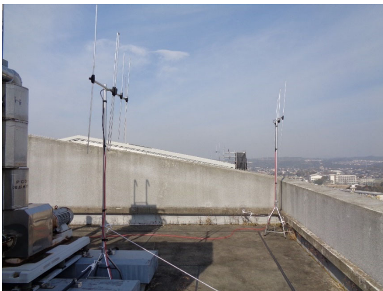
図 5 - 4 6 総合研究棟（実験局 B） 受信空中線 設置状況
