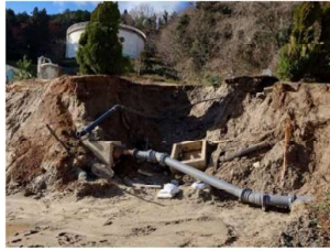
浄水場内の配管損傷（七尾市）
