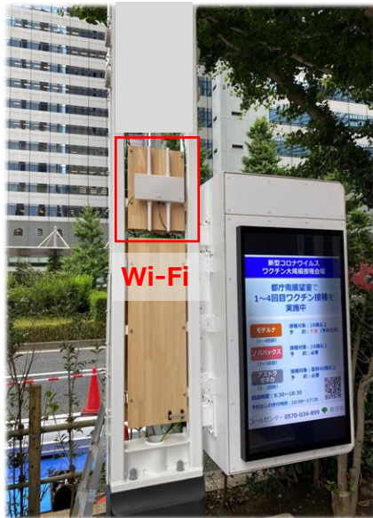
スマートポール (サイネージ) Wi-Fi AP設置(例)
