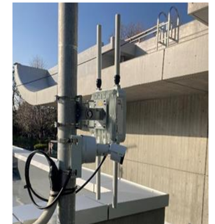
スマートポールにWi-Fi、AIカメラを設置
