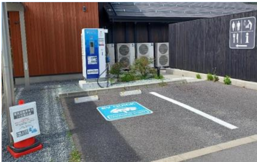
EV充電施設(宮城県道の駅おながわ)
