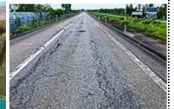
アスファルト路盤の損傷
