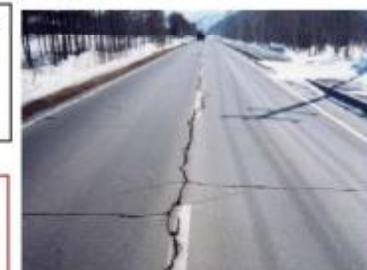
凍上災害による 舗装の損傷事例
