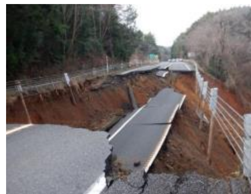
令和6年能登半島地震における盛 土崩壊状況
