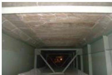
ひび割れの発生
