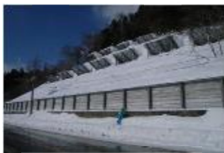
雪崩対策の例（雪崩防止柵）
