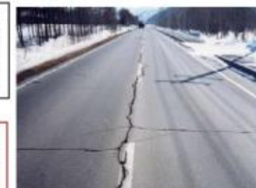
凍上災害による 舗装の損傷事例
