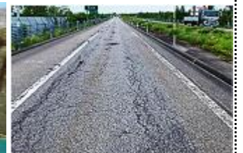
アスファルト路盤の損傷
