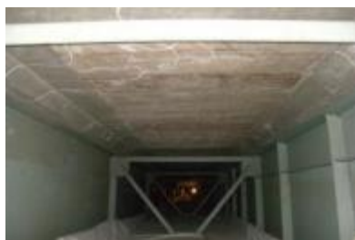
ひび割れの発生
