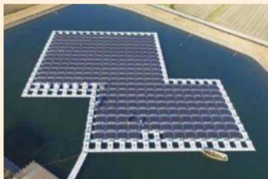
ため池フロートソーラー発電所
