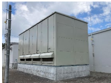
大容量大型蓄電池パッケージ
