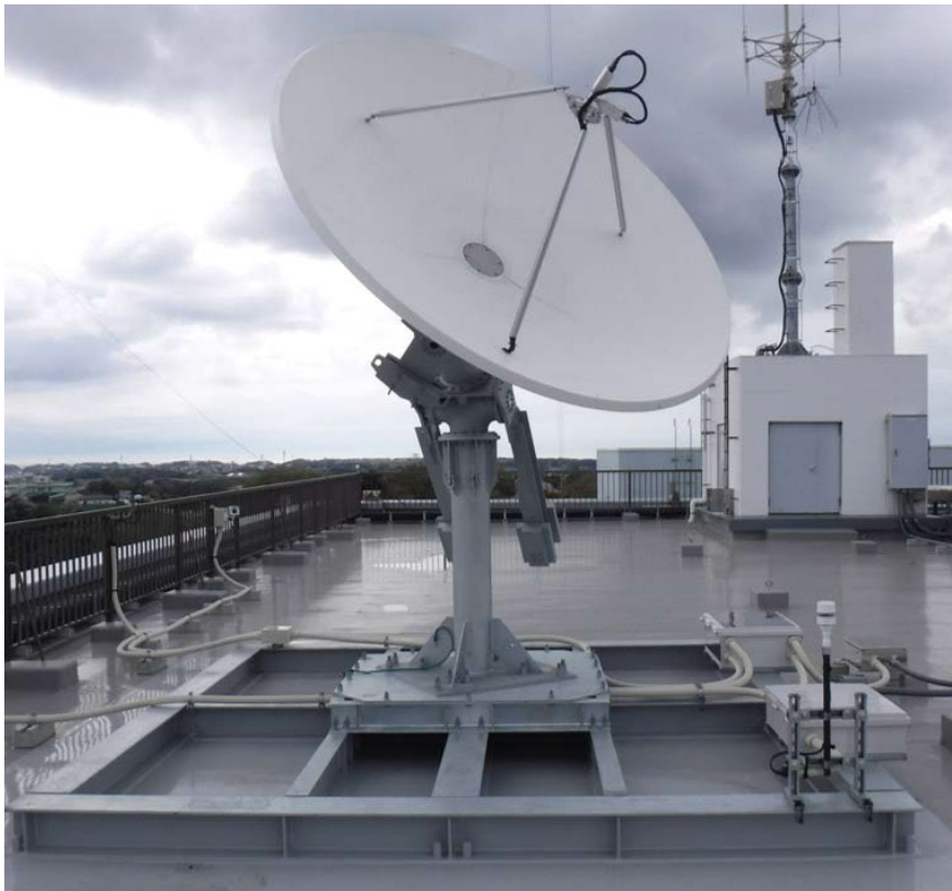
Ku帯非静止衛星監視試験設備（アンテナ部）
