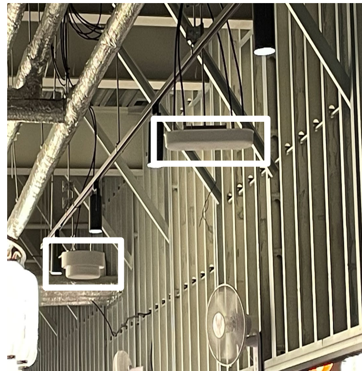
※露出許容箇所(アンテナ露出パターン)
