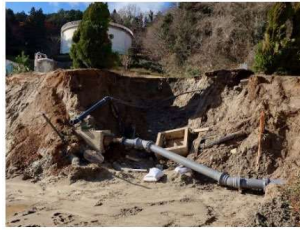
浄水場内の配管損傷（七尾市）
