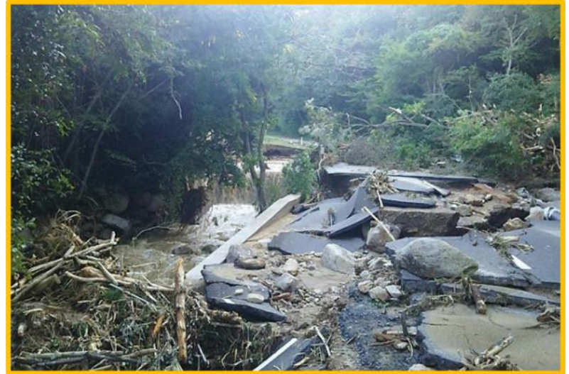
【アスファルトがえぐれて通行不可】
