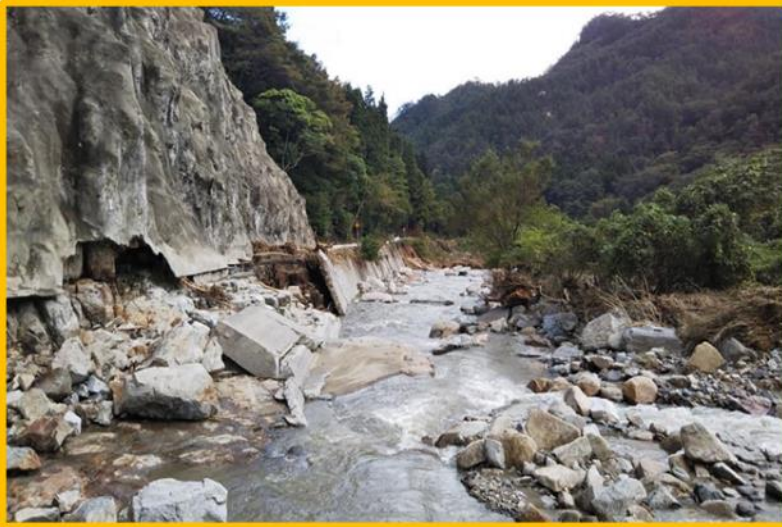
【川沿いの県道の道路が崩壊】
