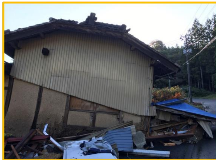
【土砂に押されて家屋倒壊】
